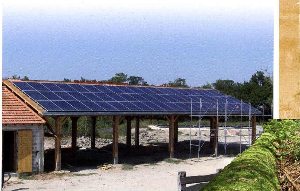
Panneaux solaires photovoltaïques sur la bergerie du Marais du Vigueirat
